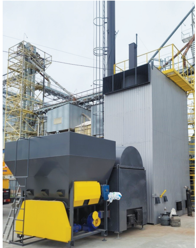
Рисунок 3 – Теплогенераторний комплекс (ліва частина фото: бункер-дозатор палива; в центрі – теплогенератор; праворуч – теплообмінник)
