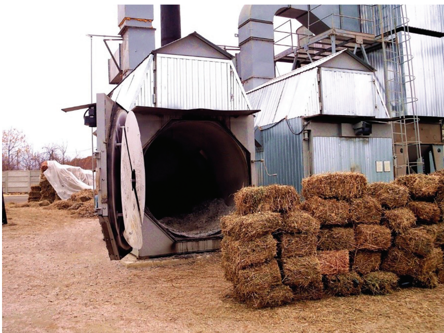
Рисунок 1 – Теплогенератор моноблочного типу (теплова потужність – 0,65 МВт; загальний вигляд у складі зерносушильного комплексу)
