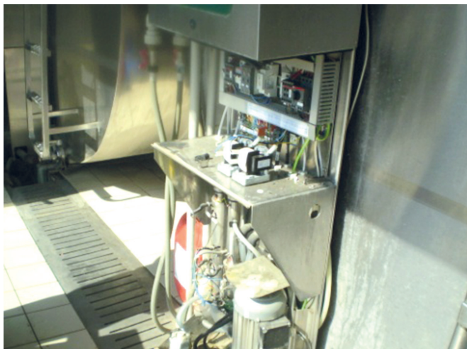
Рисунок 2 – Загальний вигляд автоматичної системи промивання обладнання
