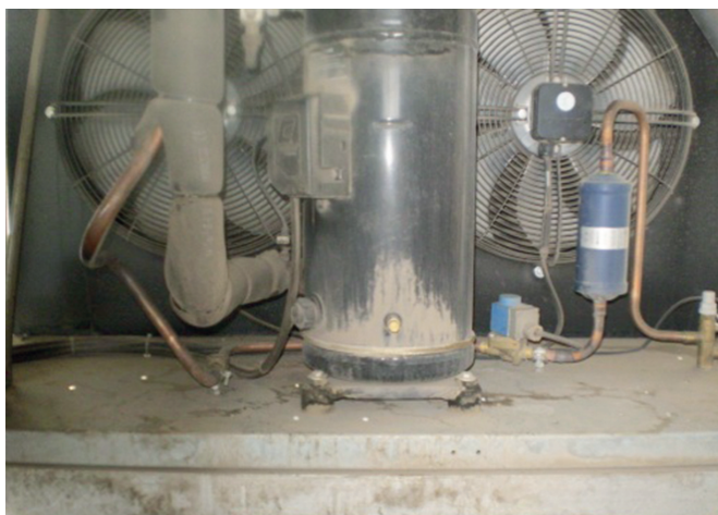
Рисунок 3 – Загальний вигляд холодильного агрегата
