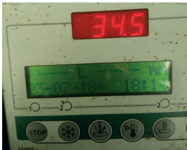
Рисунок 4 – Загальний вигляд процесорного пульту блока керування
