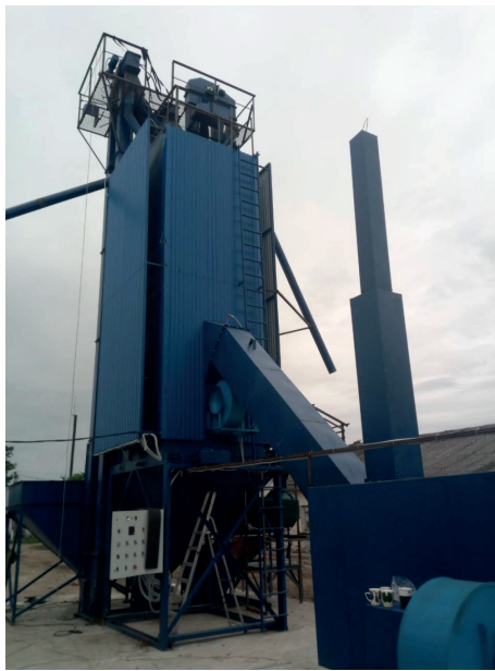
Рисунок 1 – Загальний вигляд зерносушарки ЗШР-5 встановленої в лінію зерносушіння
